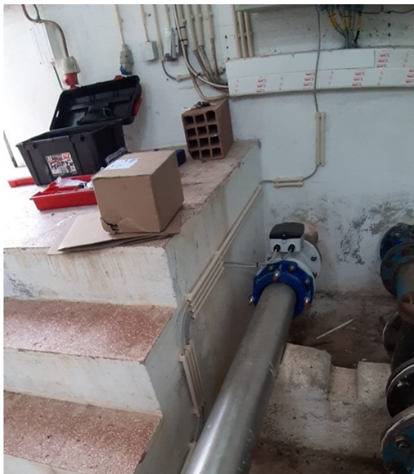
Instalação de primário de medidor de caudal eletromagnético em conduta (para recolha de volume de caudal)
